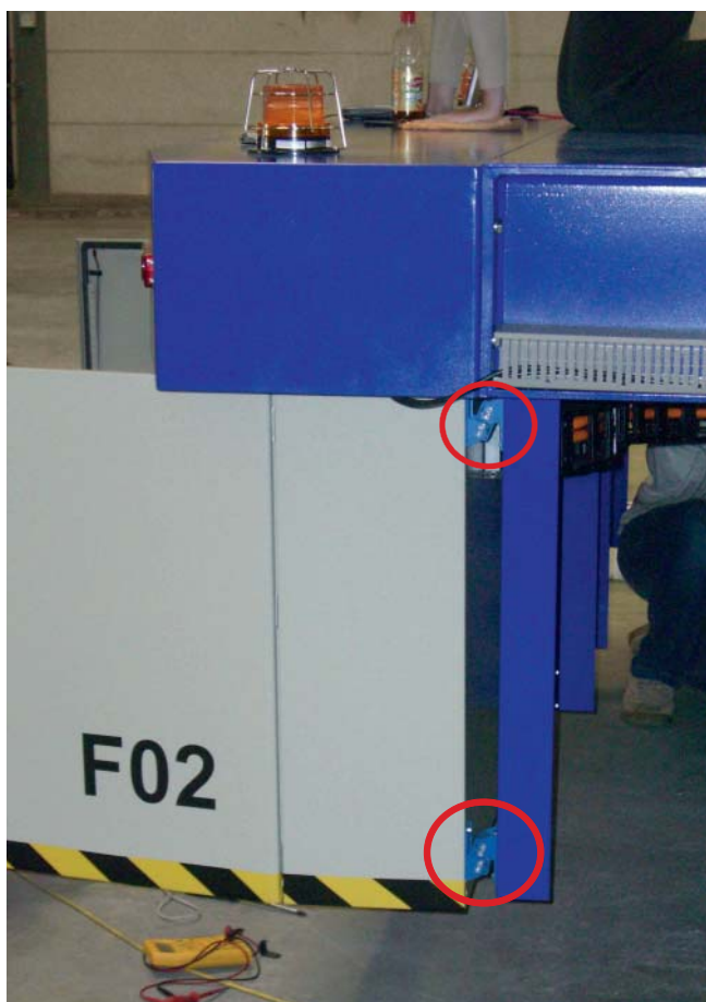
Mobile Schaltschrank-Lagerung (hängend) mit ESL
